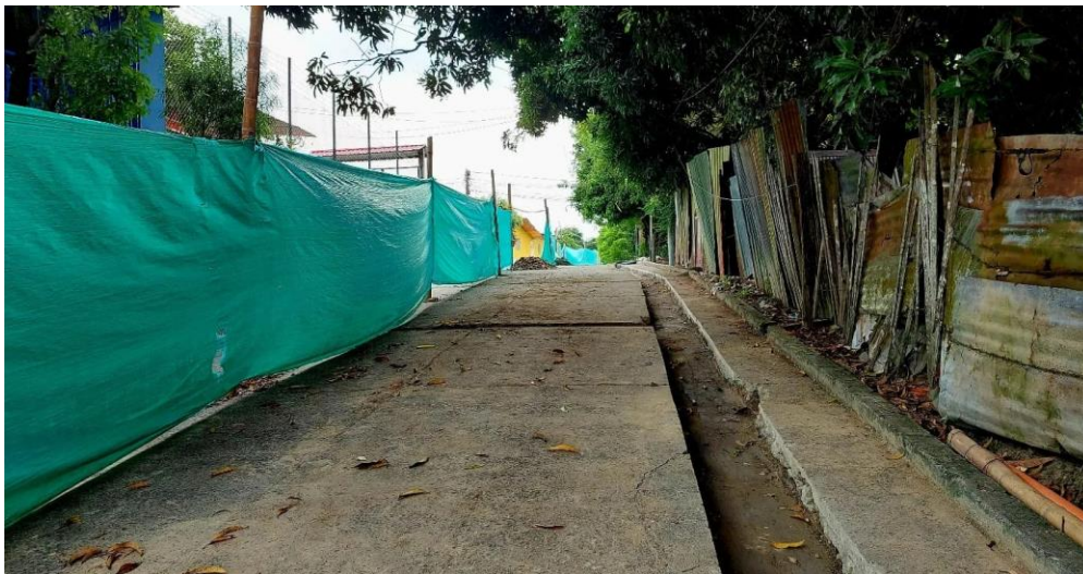
Panorámica de la obra de reposición de red de acueducto de la vía Calle 22 entre Carreras 10A, 11, 11A, 11B, 12 del Barrio Las Margaritas
