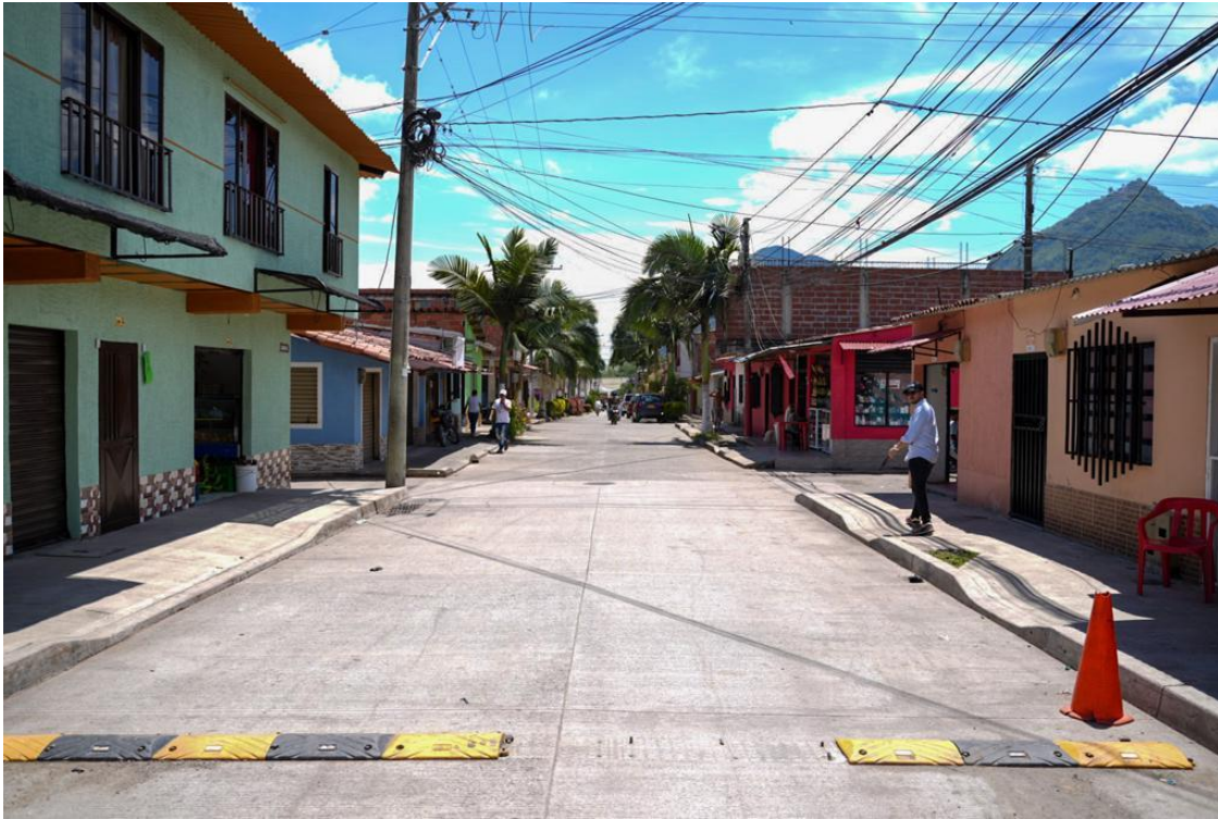
Panorámica de la obra de reposición de redes de acueducto, alcantarillado y pavimentación de la vía en los sectores Carrera 8 entre Calles 19b a 22 del Barrio Renán Barco
