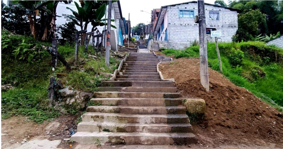
Escalas Sector Pedrito Osorio, obra con inversión de inversión de $185.953.324 por parte de Empocaldas.
