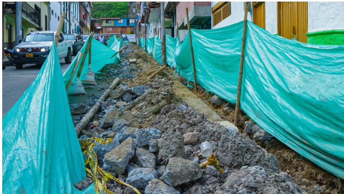
Panorámica de la obra de reposición de red de acueducto en la Calle 9 entre Carreras 2 y 3
